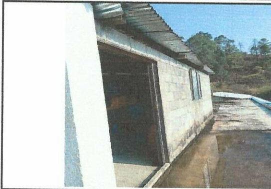
Foto 1: Se realizará el repello de la pared de la bodega escolar debido a que, en época de invierno, se filtra agua en el interior.
