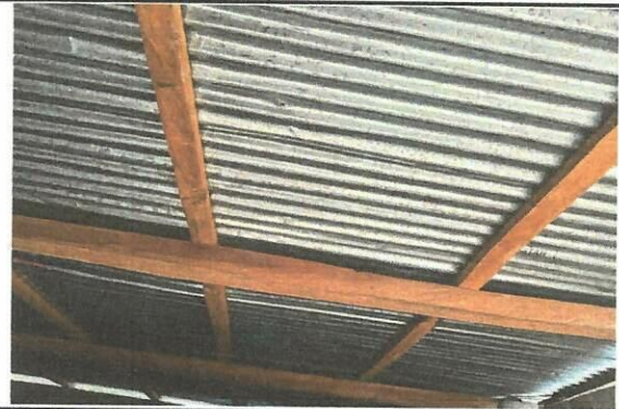
Foto 2: Se llevará a cabo el mejoramiento de estructura (costanera) para el soporte del techado de la bodega escolar, ya que las reglas de madera y lámina están deterioradas y se filtra agua en su interior.
