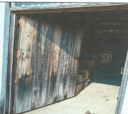
Foto 4: Es necesario instalar una nueva puerta en la bodega escolar, ya que la actual está deteriorada y afecta la seguridad y funcionalidad del espacio.
